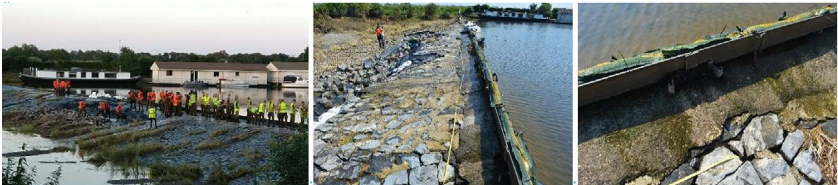
Figuur 4.8: Stuw bij Bosscherveld: noodreparatie met assistentie van het leger (foto Wilbur van Beijnen, Rijkswaterstaat), overzicht kring na reparatie (vloedmerken nog zichtbaar bij de begroeiing op de achtergrond), detail verankering stalen rand.
